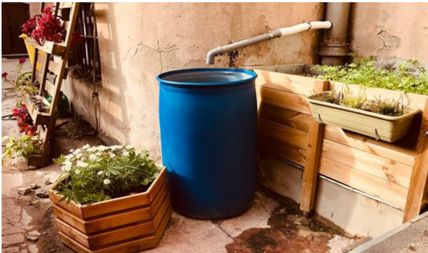
Zbiornik na deszczówkę zainstalowany w Akademiku Wspólnoty Chemin Neuf w Łodzi
